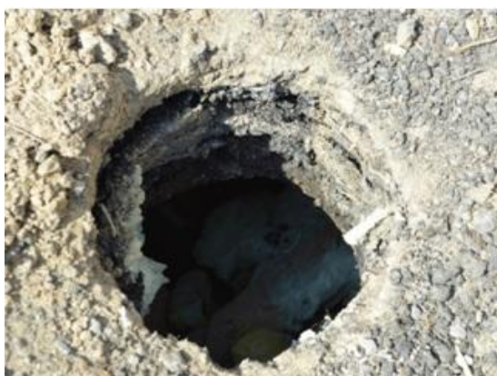
Obr. č. 26 Díra v silnici II/370 (Foto: Horní Město, 2013)
