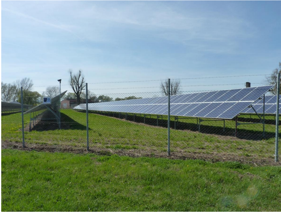
Obr. 11: FVE v obci Babice (zdroj: vlastní foto)
