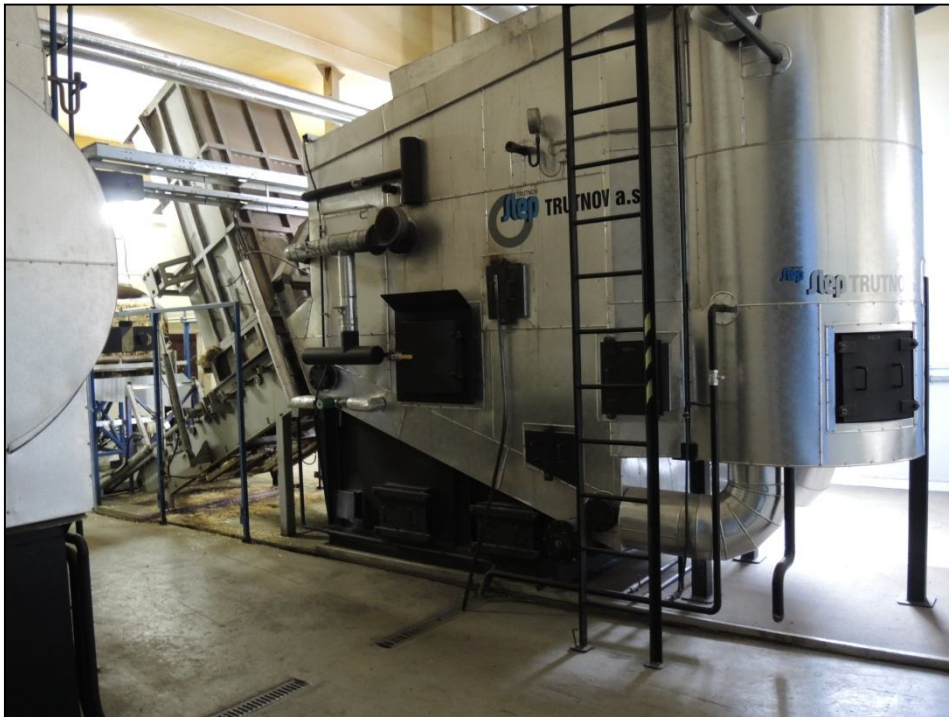
Kotel na slámu (foto autora, 2013)
