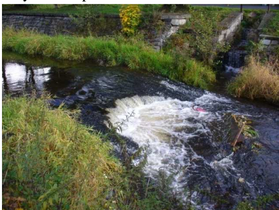
Obr. 17: Podemletý splav v blízkosti ulice U potoka v Rýmařově
