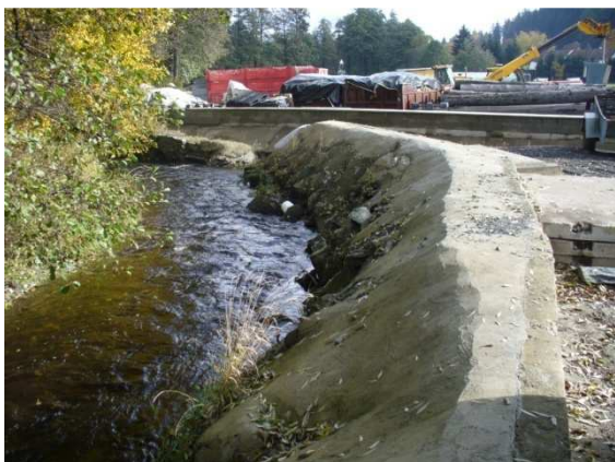
Obr. 23: Neadekvátní úprava břehu v Jamarticích
