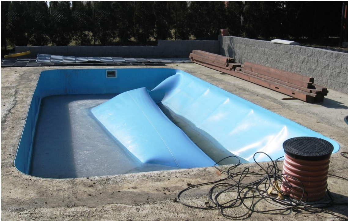
Obr. 27: Zničený bazén vlivem narušení meliorací
