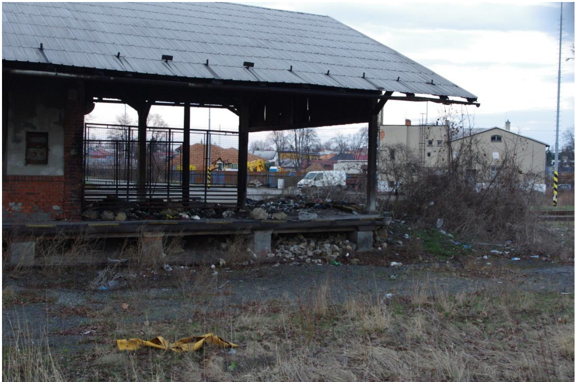
Obrázek č. 30: Zanedbaná budova v areálu vlakového nádraží v Novém Jičíně Zdroj: vlastní fotografie
