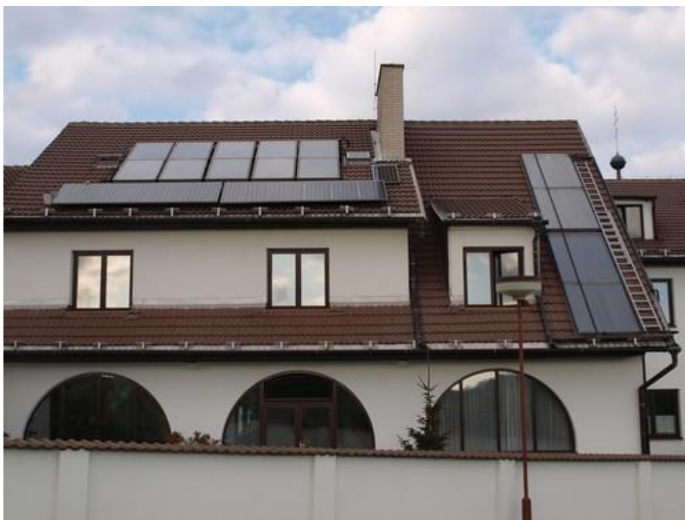
Obr. 27: FVE v obci Vilémov
