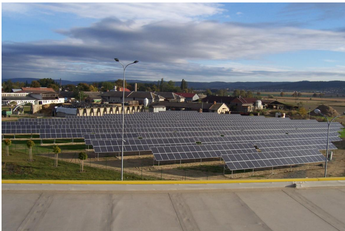
Příloha 5: FVE Chválkovice na poli po druhé etapě, archiv CHS Solar Source a.s.
