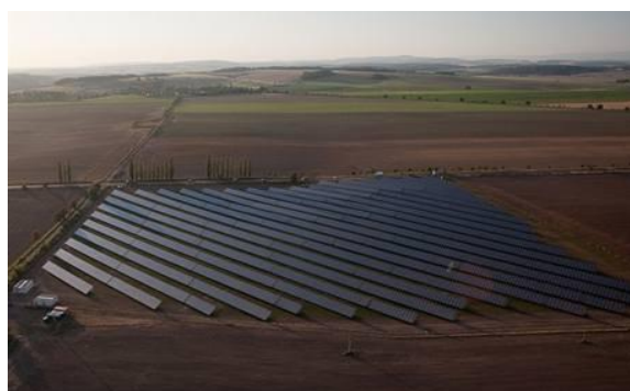
Obr. 44: Fotovoltaická elektrárna ve Smiřicích
