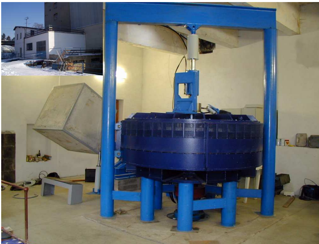
Obr. 23 Zařízení na výrobu elektrické energie v MVE Červany Foto: P. Dohnal, 2012
