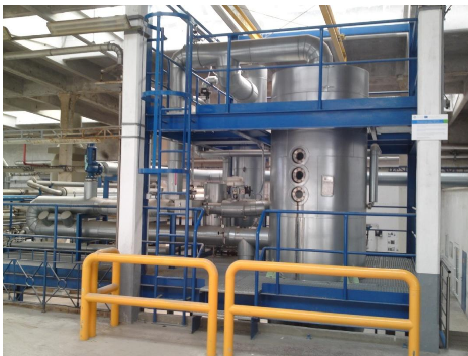
Obr. 39: Nová parní odparka pořízená s příspěvkem OPŽP. Foto: Autor, 2012
