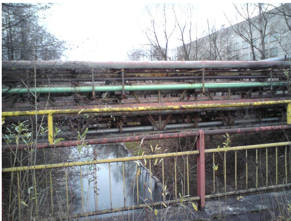
Potrubí vedené po mostě u Dolu Darkov (I. Siudová, 13. 11. 2010)
