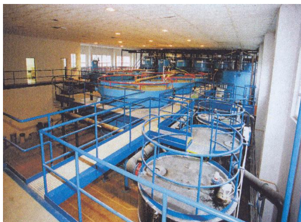
Obr. 13: Zařízení uvnitř ČDV Oslavy (foto Hana Staňková, 2011)
