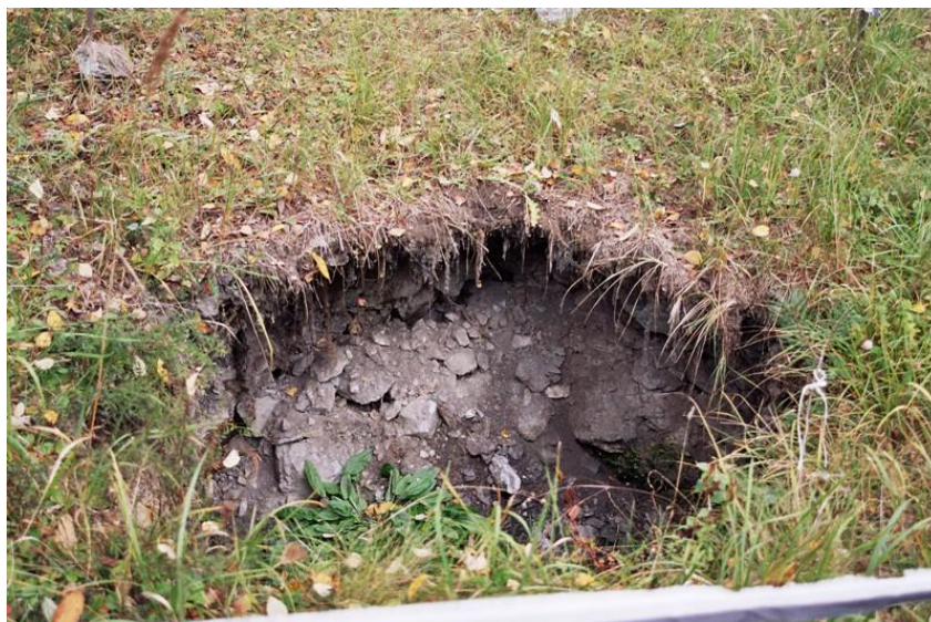
Obr. 6: Propad důlního díla na povrch
