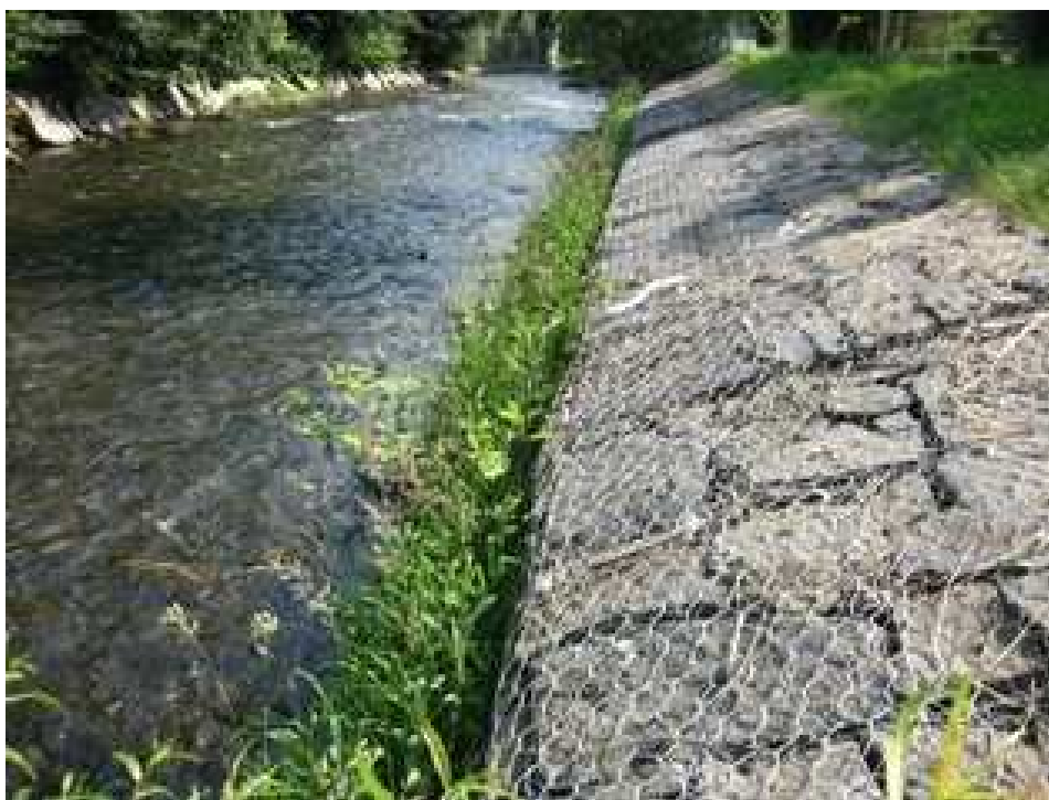
Obr.8.4.1: Stabilizovaný sesuv v obci Rapotín (Foto: Petra Janků, 1.7.2010)
