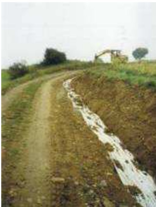
Obr. 8.3.1: Odvodňovací drén (Zdroj: http://geologie.vsb.cz )
