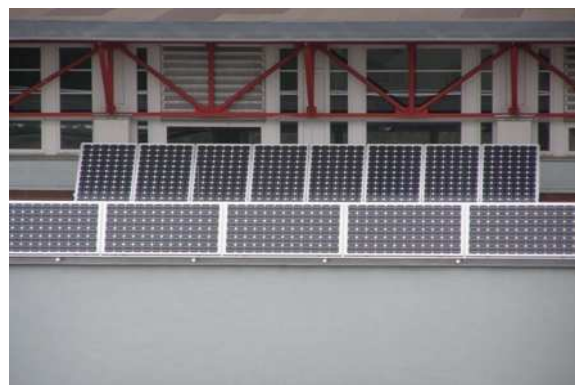
Obr. 22 Pohled na fotovoltaické články na střeše gymnázia Uničov
