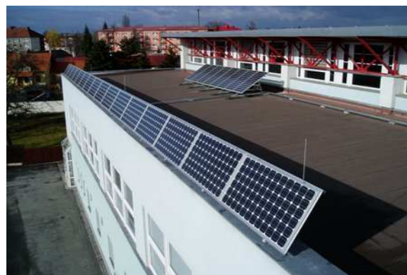
Obr. 23 Rozmístění panelů na střeše tělocvičny Zdroj: www.kr-olomoucky.cz
