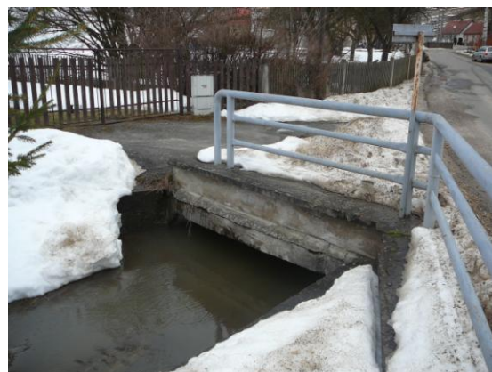
Obr. 9: Přemostění Bělského potoka s nedostatečnou kapacitou. (2.)
