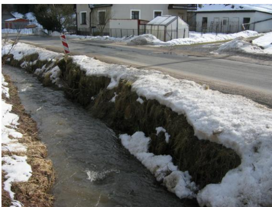
Obr. 14: Podemílání silnice č. 363. (1.)
