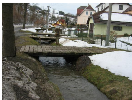
Obr. 10: Mostky s nedostatečnou kapacitou. (7.)
