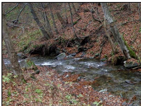
Obr. 40: Břehové nátrže Mertě (M. Ponížilová, 26. 10. 2007)
