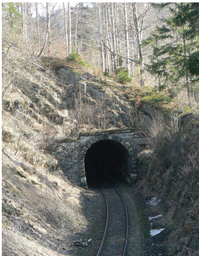
Obr. č. 24: Tunel na železniční trati Olomouc – Krnov u Jívové (Foto: M. Matoušová, 26.3. 2010)
