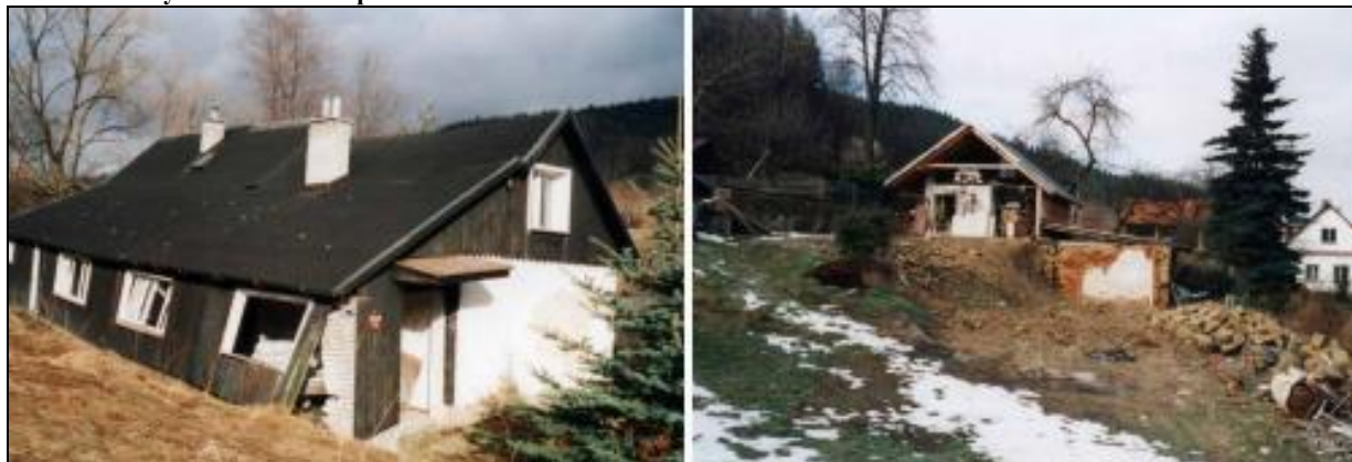
Obr. 13: Domy v obci Růžďka postižené sesuvem
