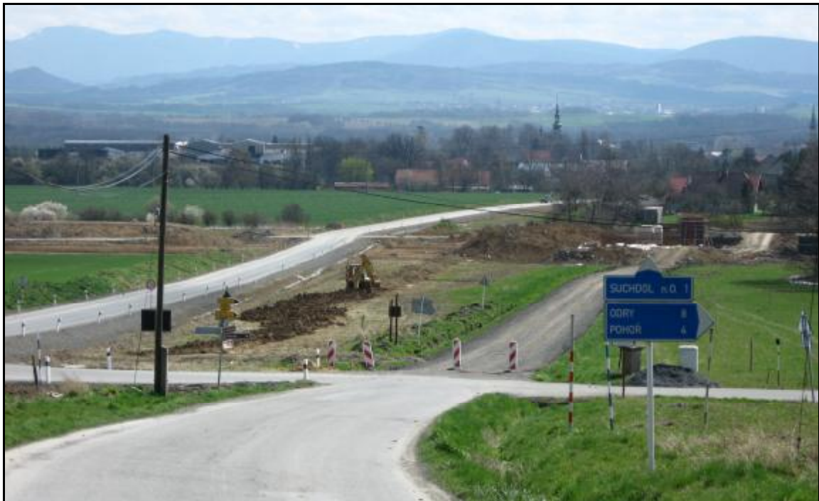
Foto č. 6: Stavba dálnice v úseku mezi obcemi Suchdol a Kletné (Pavčina Nývltová, 10. 4. 2008)
