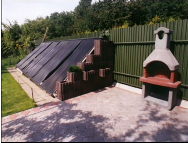
Obr. č. 4: Solární kolektory
