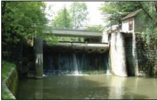
Obr. 1: Malá vodní elektrárna
