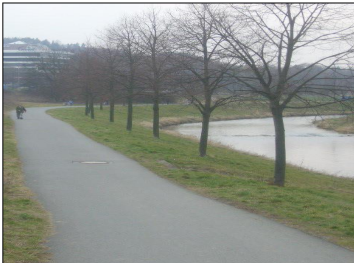
Příloha 5: Uměle navýšený agradační val lemující tok Dřevnice v katastru Příluky, zdroj: Jakubová, 2014
