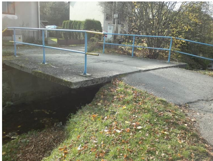
Obr. 2: Špatný technický stav mostu v Březnici
