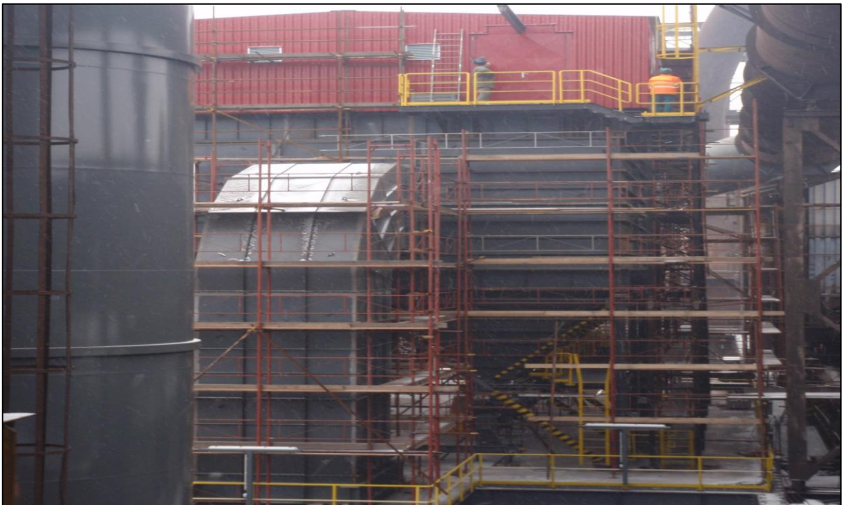
Obr. A.2 Montáž filtrů na provozu VP (zdroj: TŘINECKÉ ŽELEZÁRNY, interní dokument, 2014)
