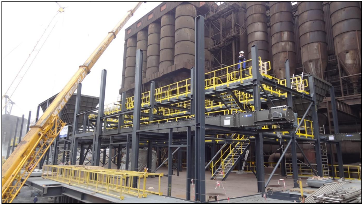
Obr. A.3 Výstavba nového filtračního zařízení na provozu KKO (zdroj: TŘINECKÉ ŽELEZÁRNY, interní dokument, 2014)
