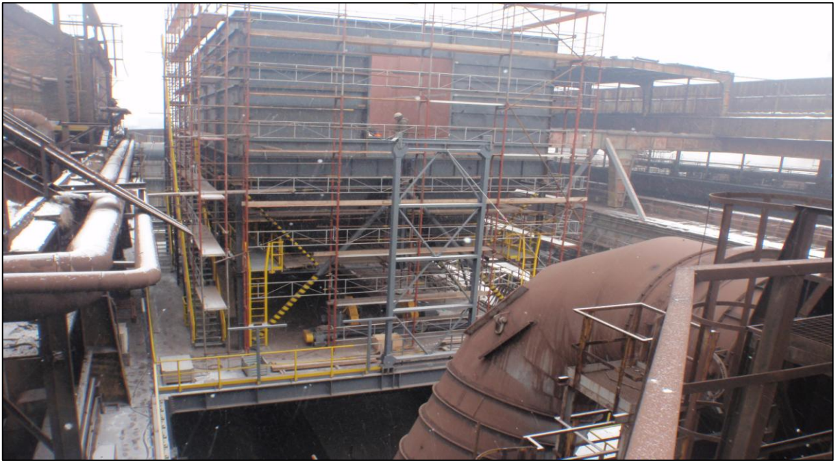
Obr. A.1 Montáž filtrů na provozu VP (zdroj: TŘINECKÉ ŽELEZÁRNY, interní dokument, 2014)
