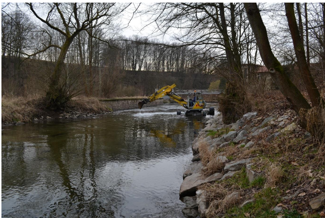
Obrázek 15 Pracovníci Povodí Labe, s. p., pobočky Hradec Králové provádějí bagrování koryta Metuje nad MVE Krčín. Autor: Lukáš Cohorna, 18. 2. 2014
