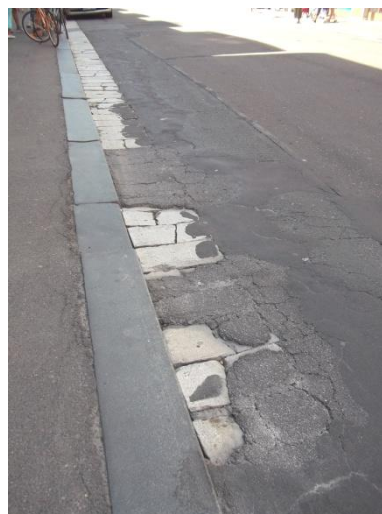
Obrázek 6.6 – Špatný stav povrchu ulice Foto: Autorka
