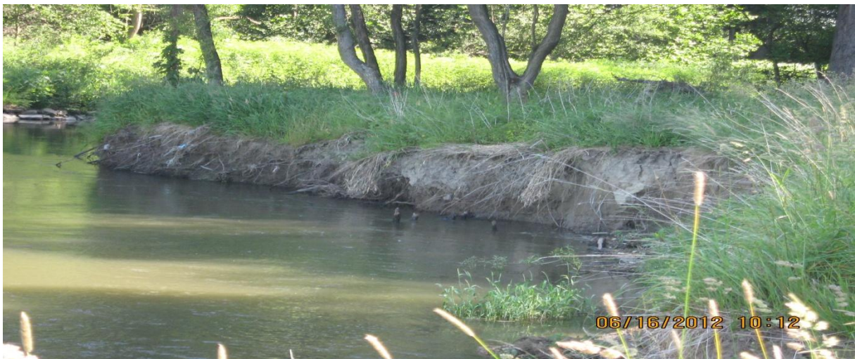
Obr. 8: Břehová nátrž v blízkosti obce Úvalno Foto: Lukáš Rychta, 16. 6. 2012
