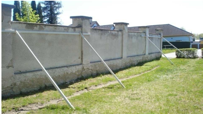
Obr. 14 Bortící se hřbitovní zeď v Sendražicích (Jiří Pospíšil, březen 2012)
