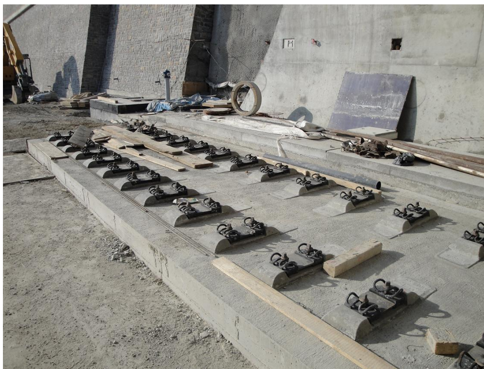
Obrázok č. 16 – Podložie koľajníc pri južnom portáli tunela Turecký vrch (Tomáš Mikulovský, 28. 1. 2012)
