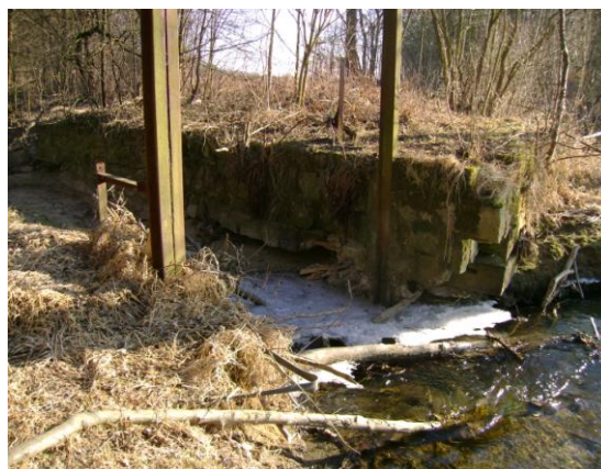
Foto 16 Ruina stavidla na Vitošovském náhonu (Drtilová, 3/2011)
