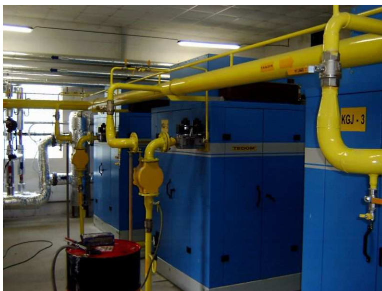
Obr. 1. Trojice kogeneračních jednotek
