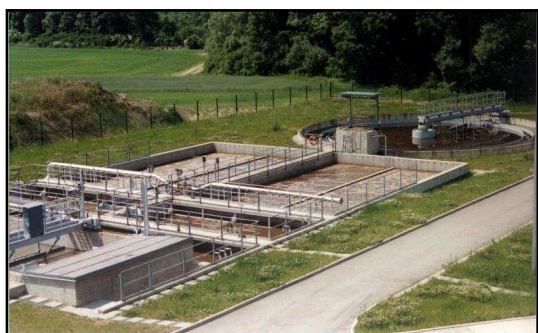
Obrázek 23 – Aktivační a dosazovací nádrže ČOV Zdroj: www.vak-km.cz
