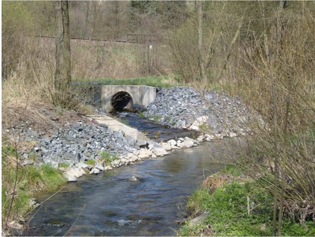
Výpustný profil vyčištěných vod do potoka Nedvědičky
