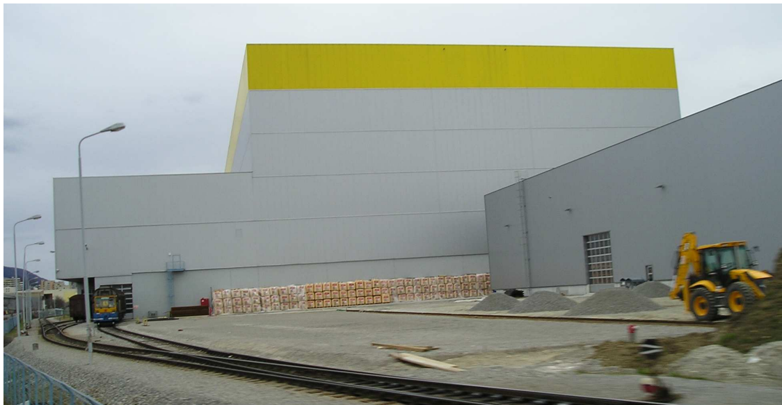
Příloha č. 13: Podniková vlečka a dokončovací práce na budově skladu s terminálem v podniku Gorenje ve Velenje
